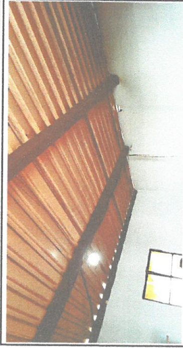
Foto1: Cambio de vigas de madera por vigasde metal en area de cocina.
